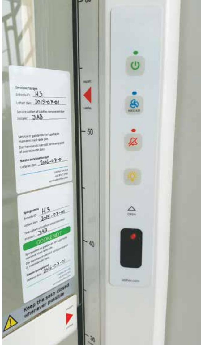
Figur 22. Eksempel på dokumentation af udført service samt spørgsmåling på et stinkskab. De røde pile på hhv. lugen samt stinkskabets side indikerer den maksimale lugehøjde, hvor service og spørgstesten er gældende.
