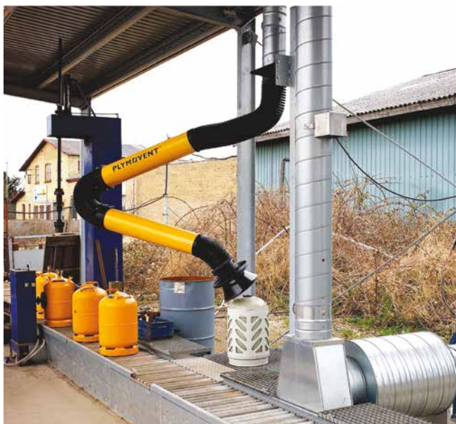
Indgangskontrol af gasflasker inden de skal renoveres. Der kan være risiko for frigivelse af gas ved defekt ventil
