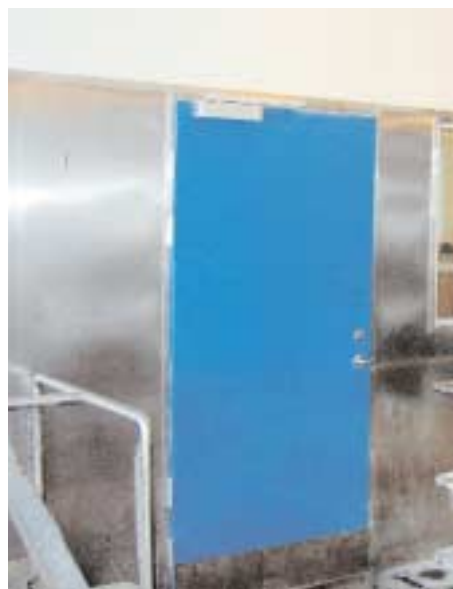
Indgang til kontrolrum etableret i 1990'erne.
