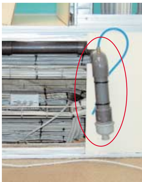
Plastrør til luftafkast fra mange maskiner.
