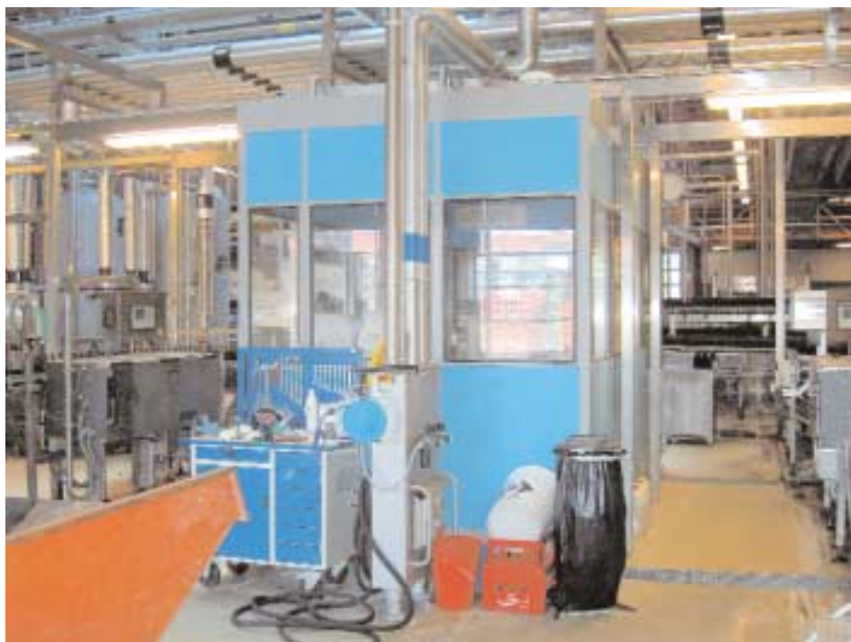
Lydisoleret operatørrum i tappehal.
