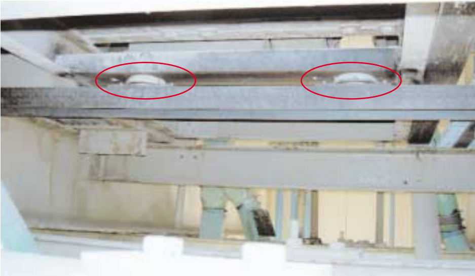
Rammen set nedefra med svingningsisolatorer.
