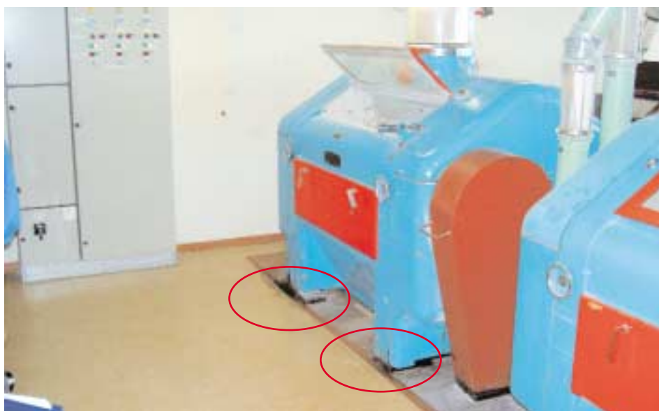
Valser opstillet på vibrationsisolerende plader.
