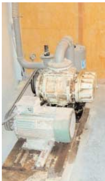
Vakuumpumpen fotograferet inde i indkapslingen.
